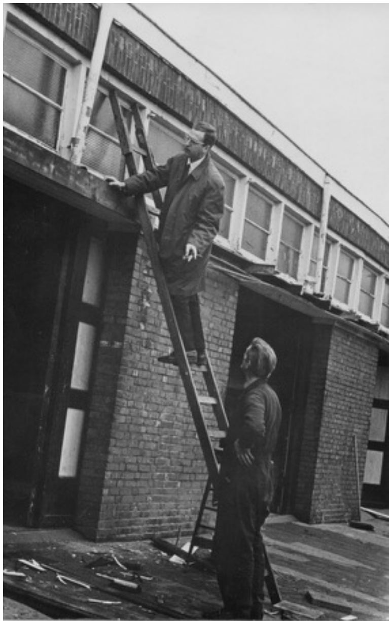
Ondertussen wordt de verrotte luifel verwijderd. Voor het lekkende dak is helaas geen geld meer.
